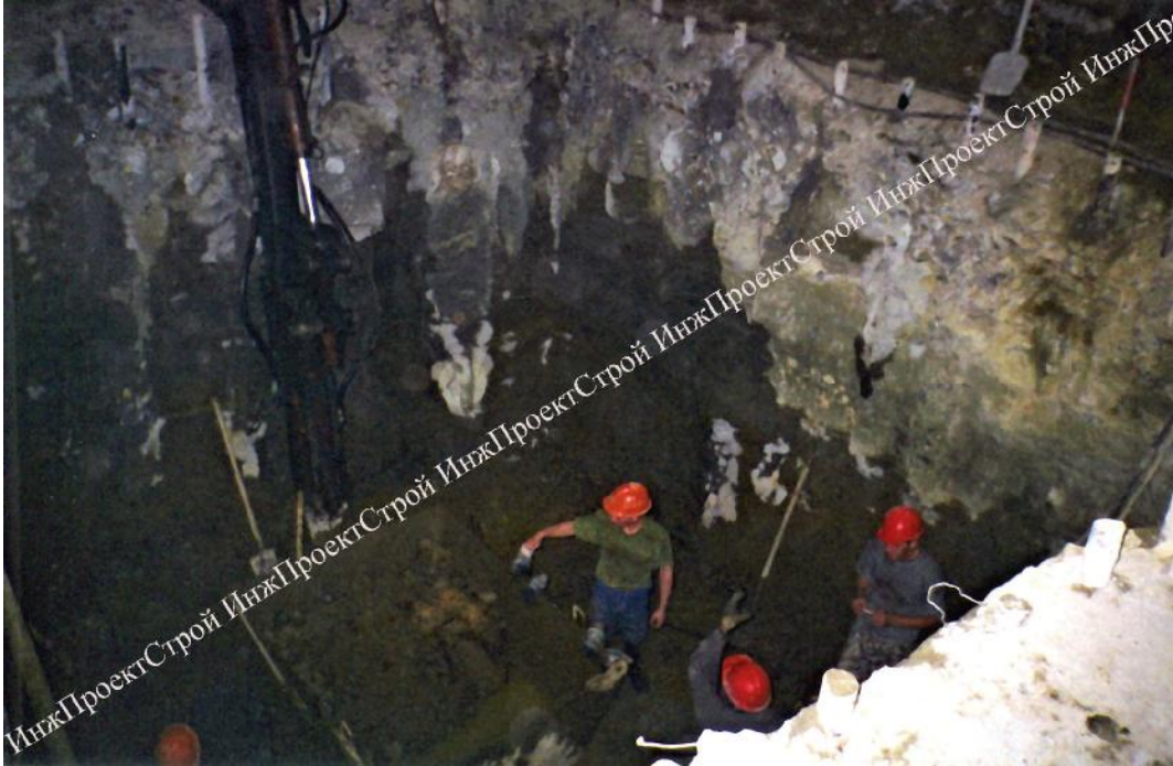
Фото 3. Завершение работ по проходке работ подземной камеры. Работы ведутся ниже уровня грунтовых вод.
